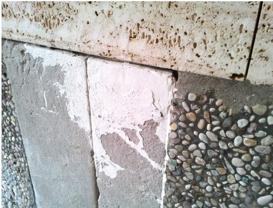
Figura 8 Dettaglio delle incrostazioni sulle parti lapidee del basamento della Sala Luzzatto, prima dell'intervento
